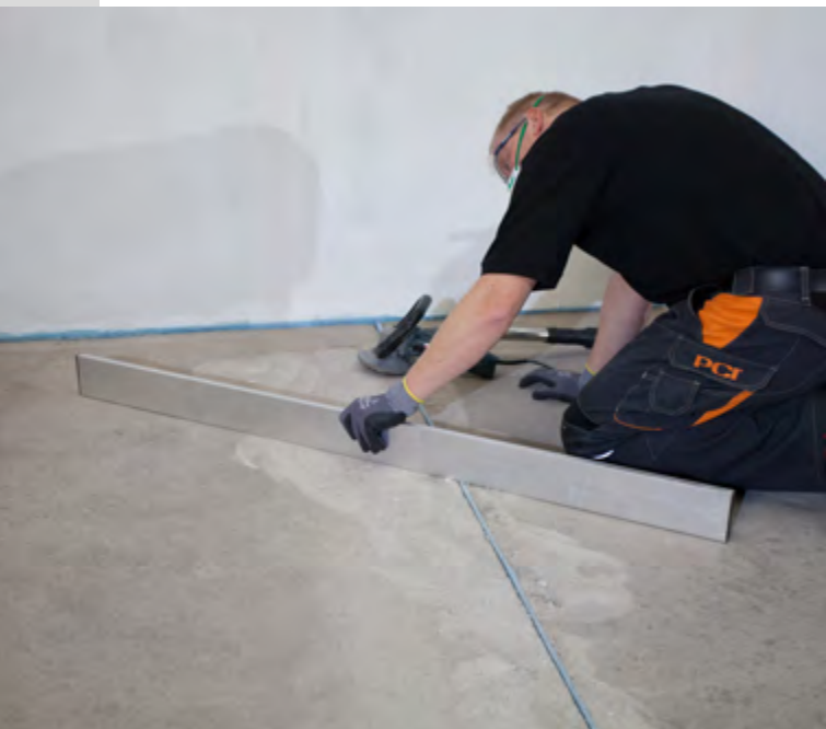
Fot. 2. Płytki wielkoformatowe wymagają bardzo dokładnego wyrównania podłoża
